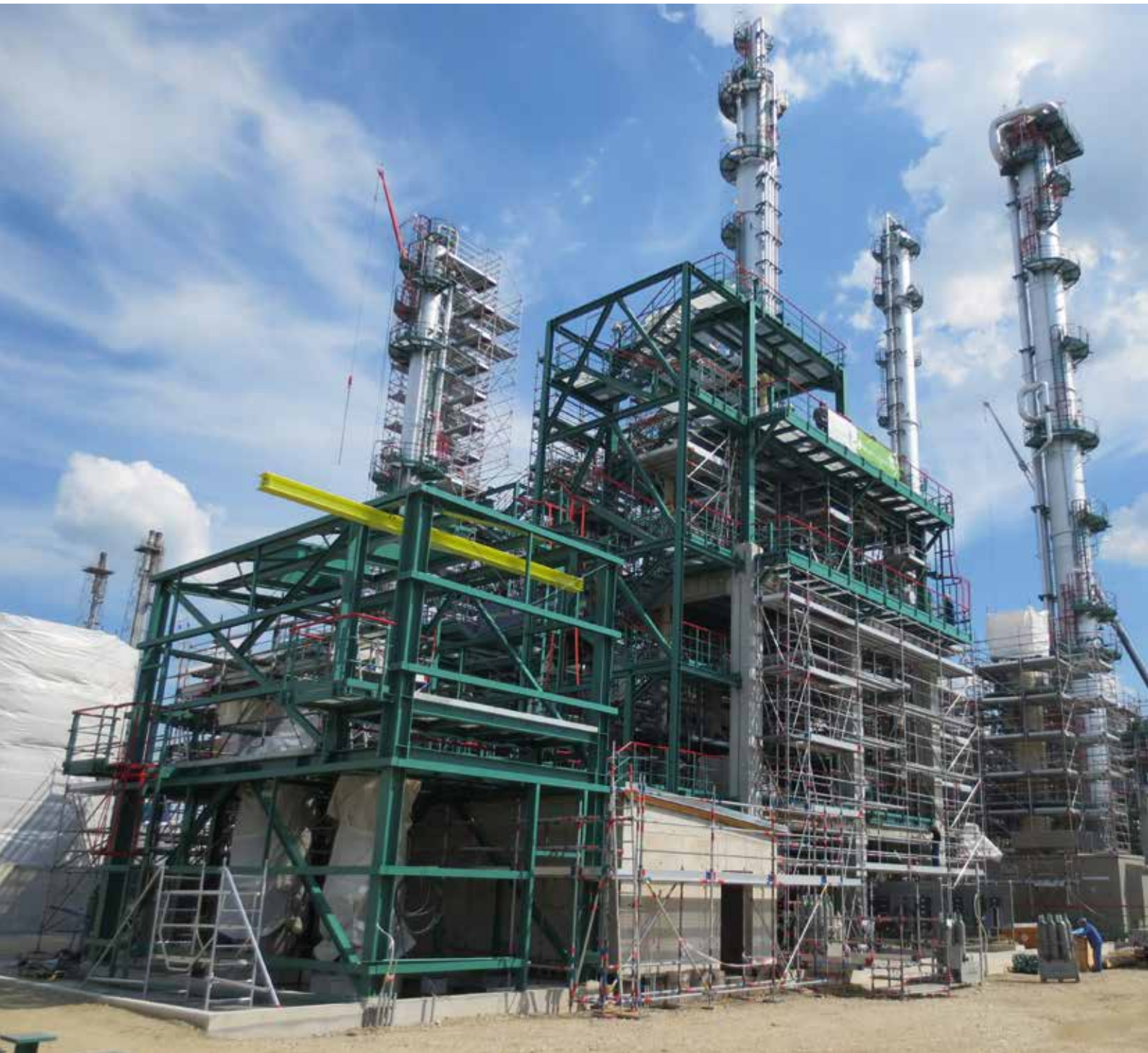
Die Butadienextraktion musste pünktlich zum Shutdown fertig sein.
