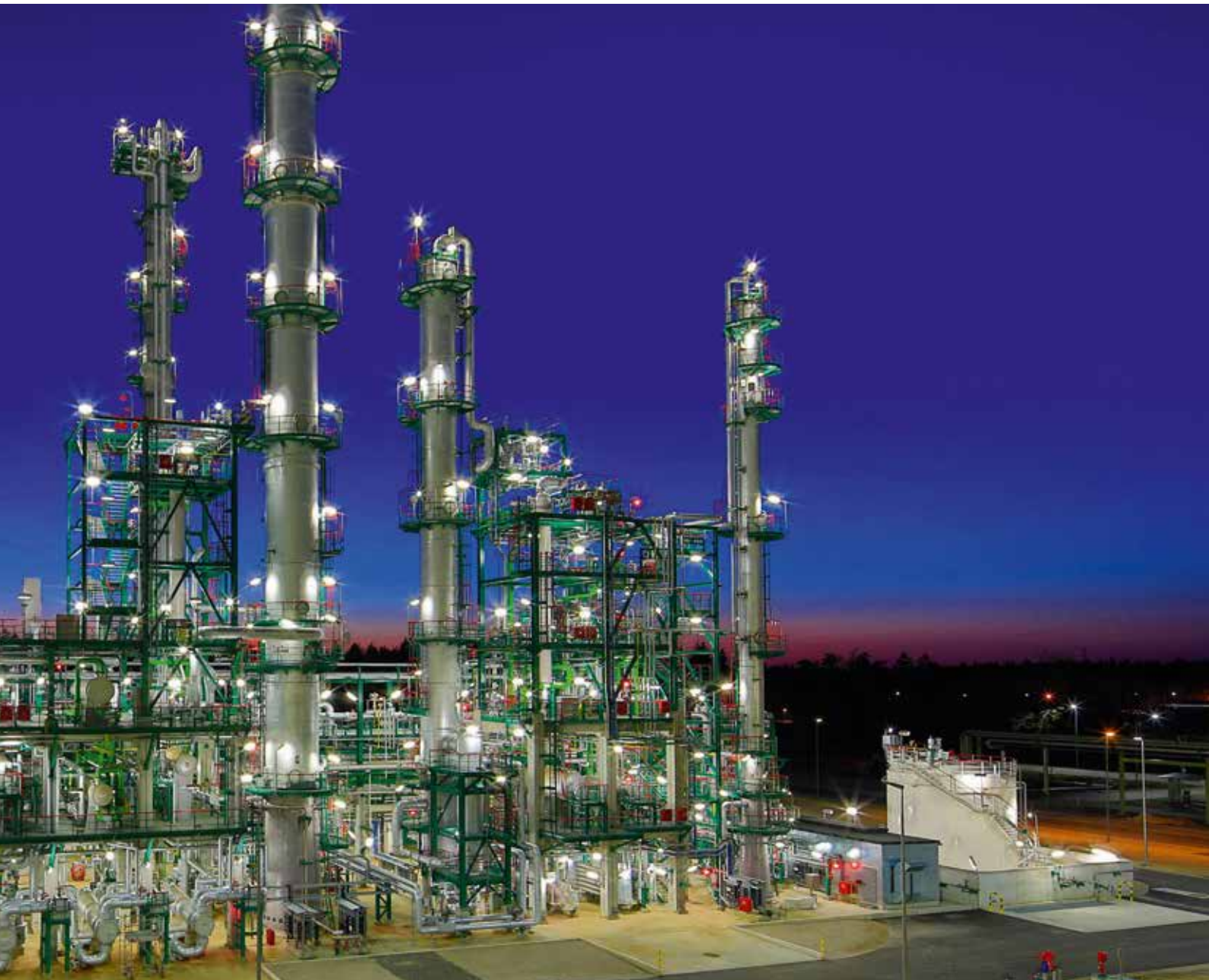
Die Butadienanlage am Standort Burghausen produziert seit dem Frühjahr 2015 zuverlässig.
