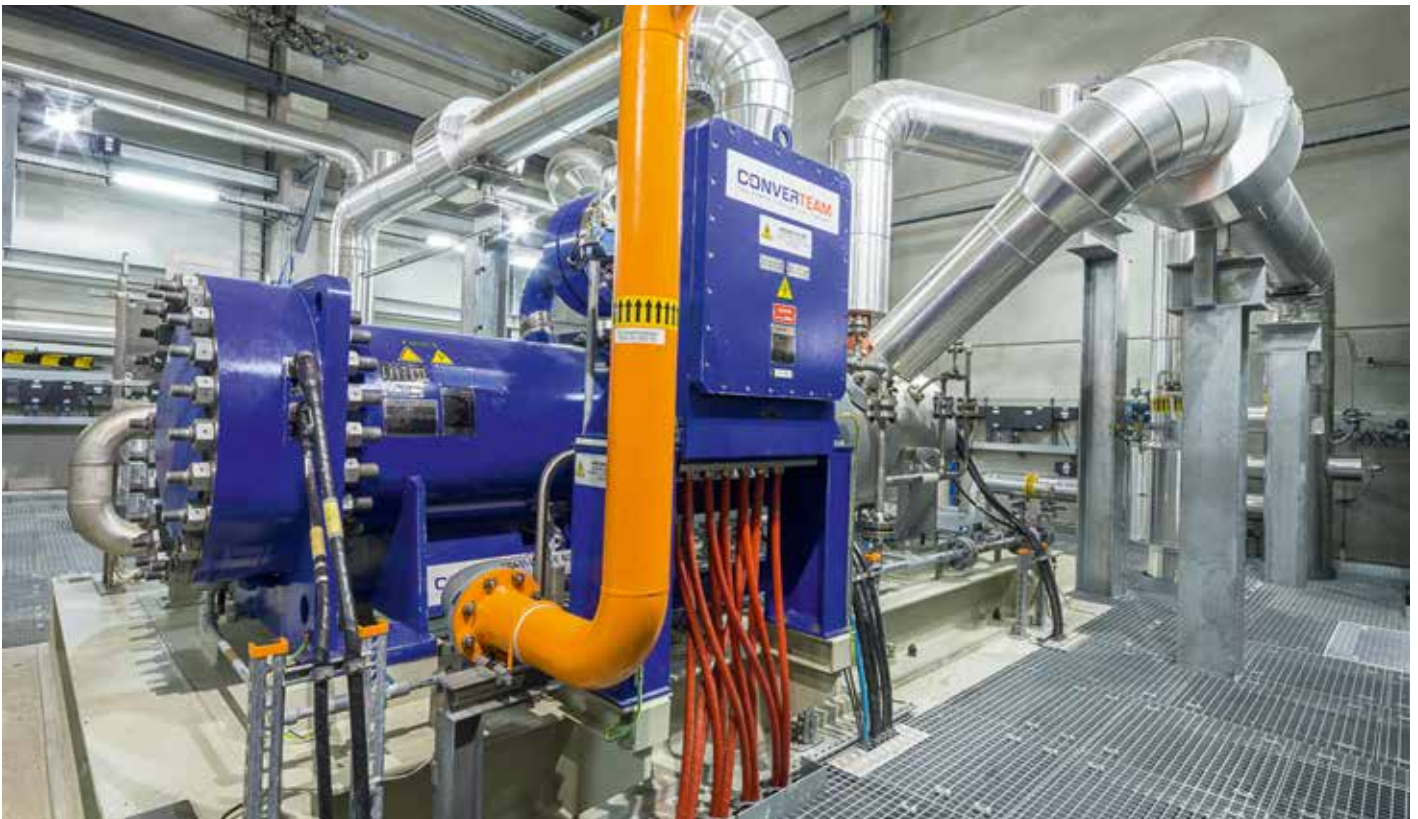
Highspeed-Erdgasverdichter mit integriertem Elektromotor und aktiver Magnetlagerung in einer Gasverdichterstation
