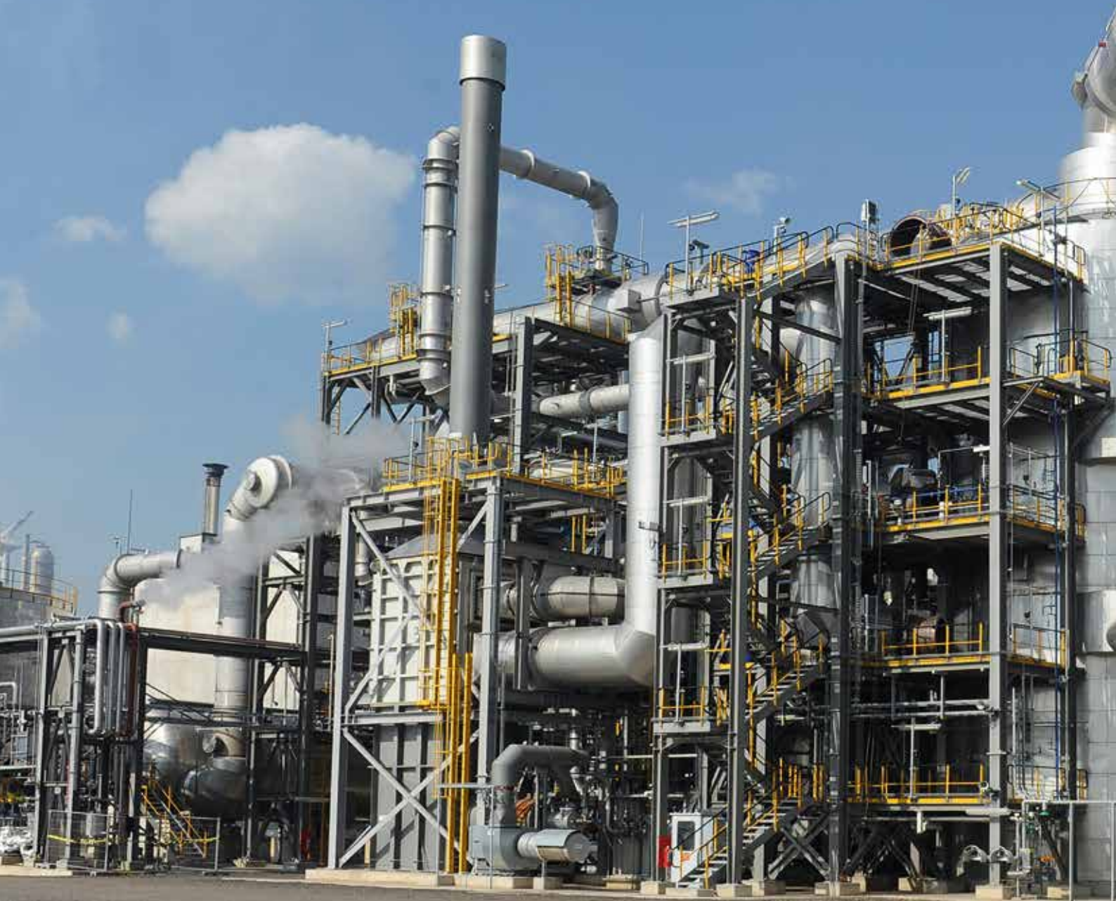
Die von HUGO PETERSEN erbaute Oleum / Schwefelsäureanlage für BASF SE in Antwerpen ist weltweit die größte ihrer Art.
